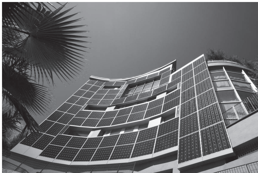
Вертикални монтирани фотонапонски модули на фасади зграде
